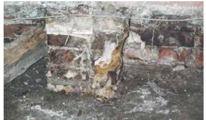
Bevordering van schimmelgroei en schade aan de bouwstof
